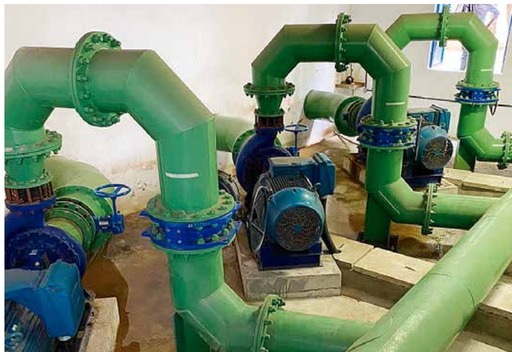
Conjunto motobomba da Estação Elevatória de Água Tratada Bela Vista
